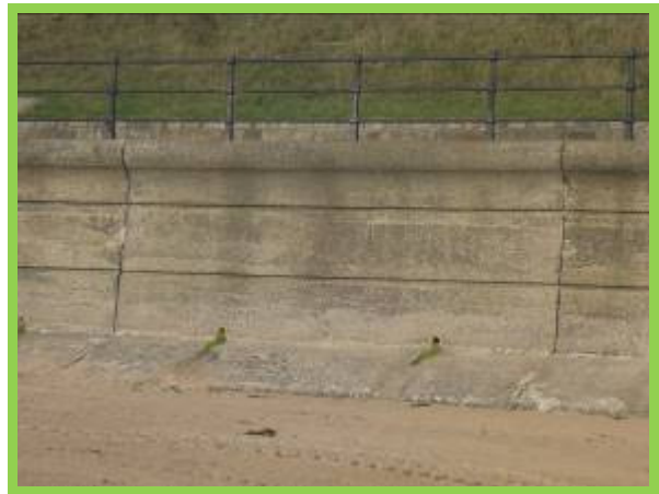
Abrasion at toe of vertical seawall (/4701C18) (/4701C18)
